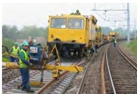
Longs rails soudés sur traverses béton
